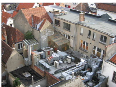
Installations techniques en intérieur d'îlot 5 et 6
